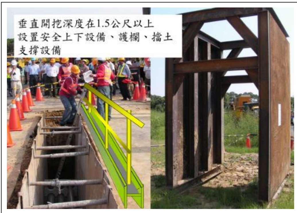
照片 18 管溝開挖深度 1.5 公尺以上，設置安全上下設備、護欄、擋土支撐設備等
