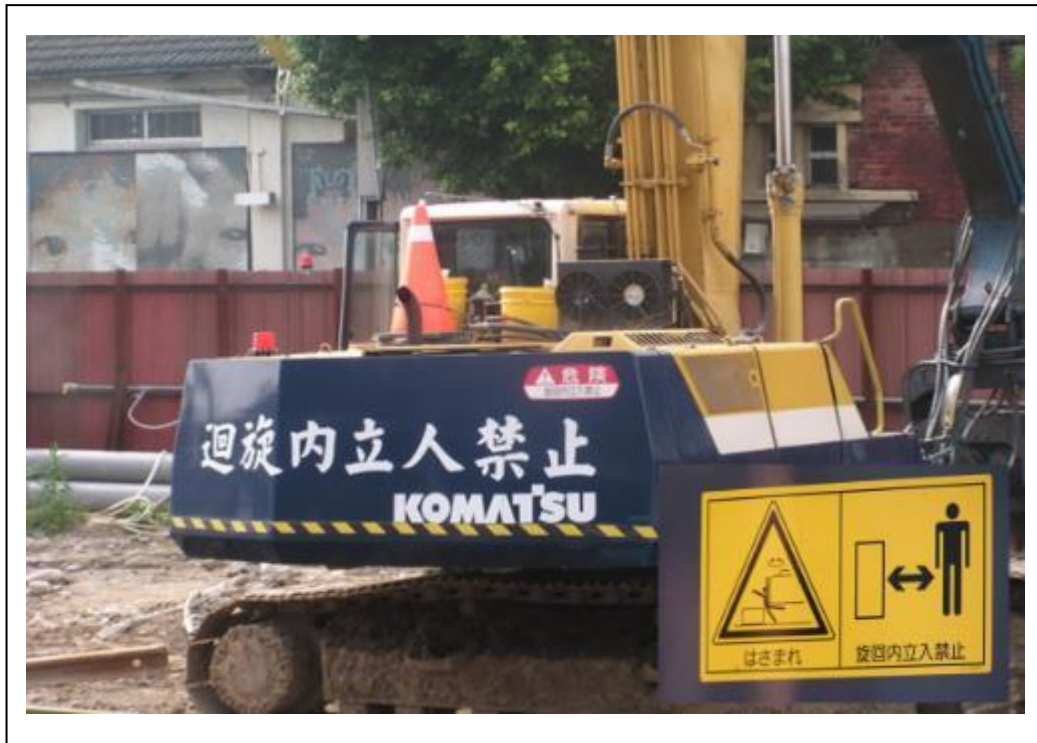
照片 09 嚴禁操作人員以外之勞工進入營建用機械之操作半徑範圍內
