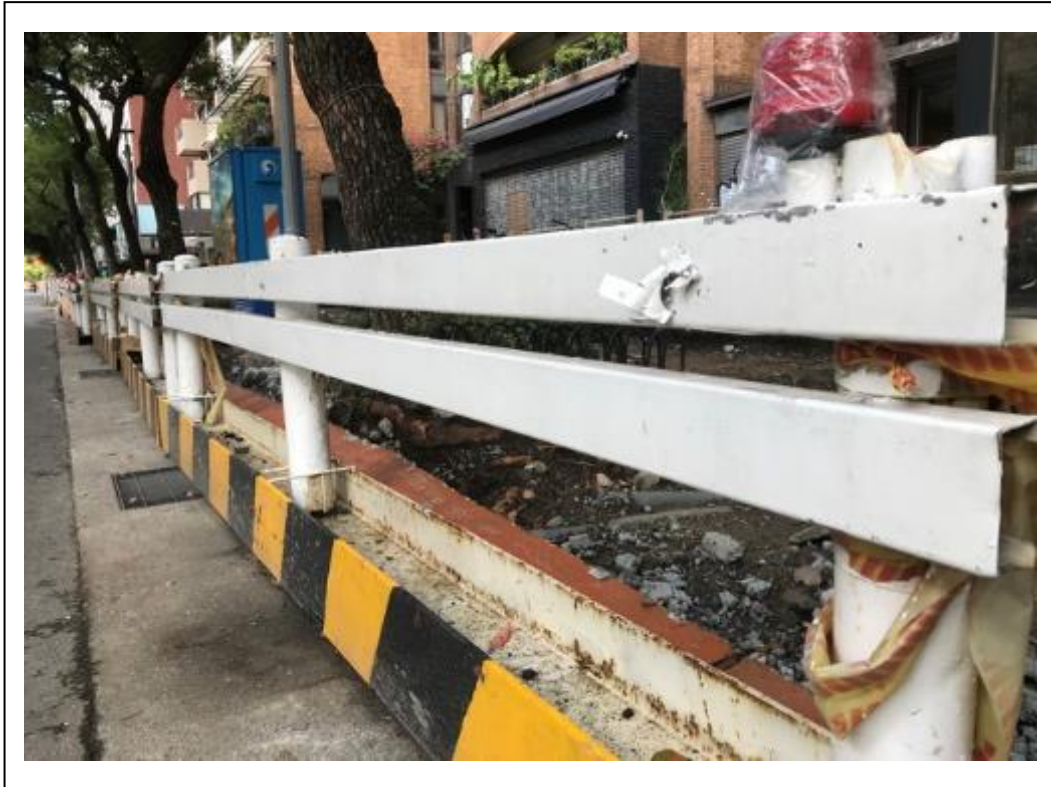
照片 17 管溝開放邊緣部分使用護欄與型鋼共構組合 參考圖
